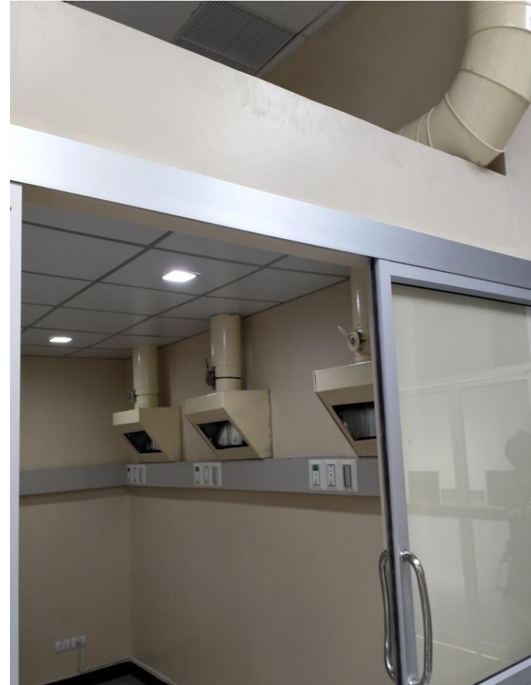
ห้องพ่นยา ER แบบ Modified negative pressure
