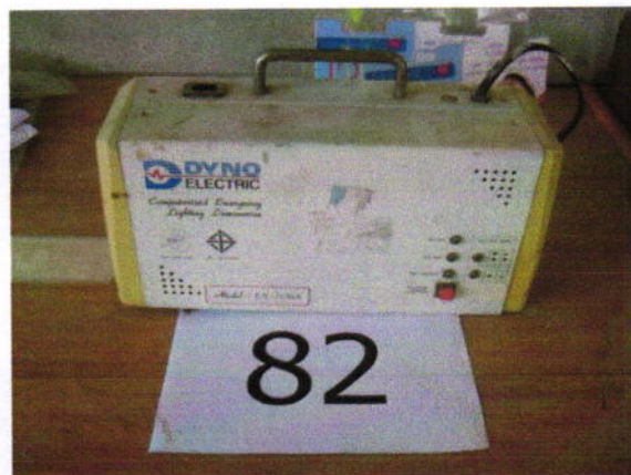
หมายเลข 82 เครื่องสำรองไฟฟ้าฉุกเฉิน ชำรุด ไม่สามารถใช้งานได้
